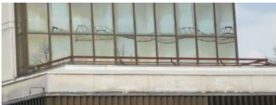
Esempio di facciata continua che presenta forti distorsioni ottiche
